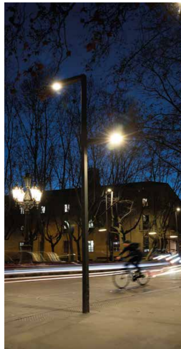
Alumbrado Público Éclairage Public Street Lighting Illuminazione Pubblica
